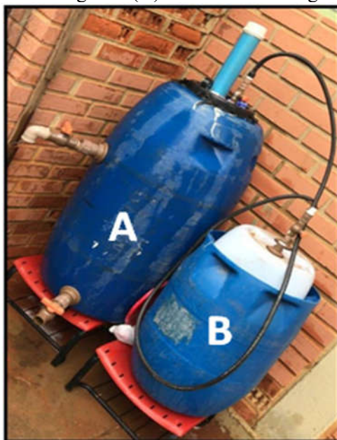
Figura 3 – Biodigestor (A) e reservatório de gás (B).
